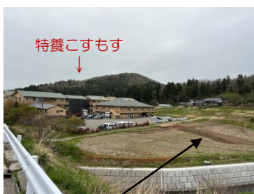
特養こすもすに向かったの地割れ (既に修復済み)
